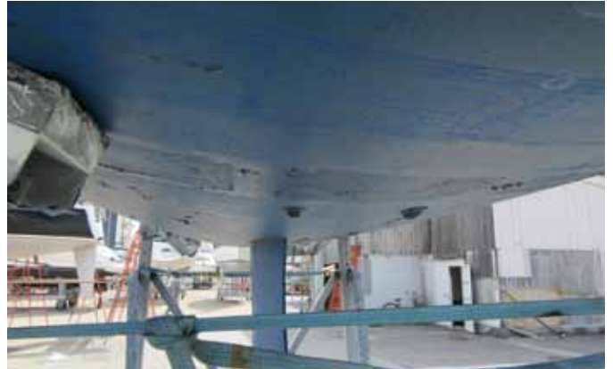
写真では少しわかりにくいのですが、底部まで剥がれが出てきています。乾くにつれてここまで徐々に剥がれが広がりひどい状態です。
